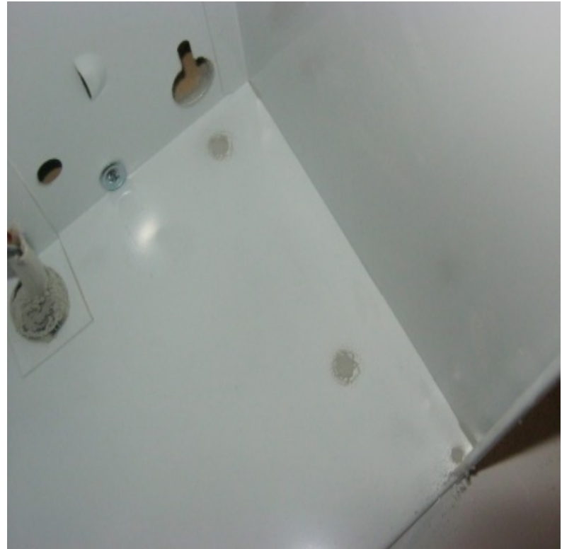
Kitchen exhaust fan
